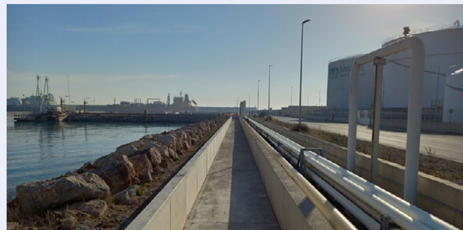
Rack paralelo al canal de Iberdrola
